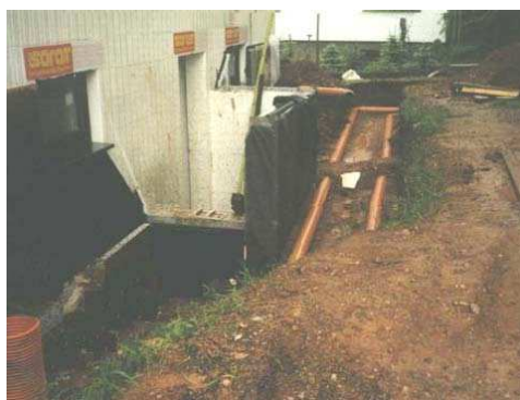
Dvě paralelní trubky zemního výměníku tepla umístěné 2 m vedle základové konstrukce
